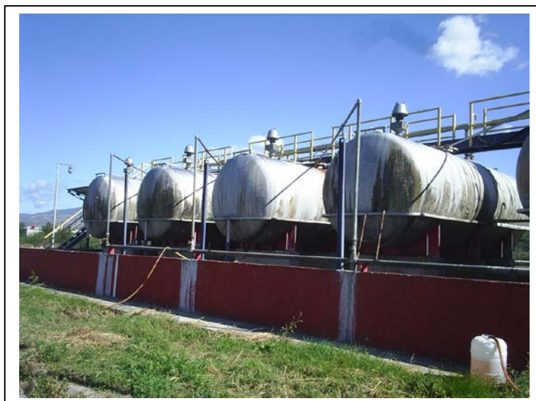
Слика V.1-1: Резервоари за складирање на запаливи течности
