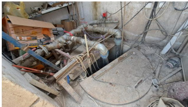
Слика 11 Пумпи за црпење вода
