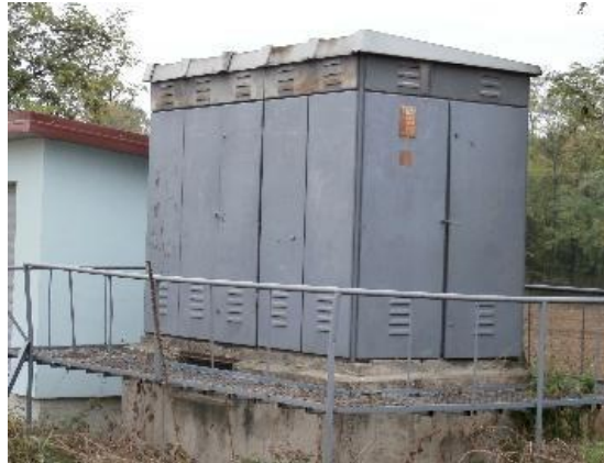
Слика 12 Трафостаница за обезбедување електрична енергија
