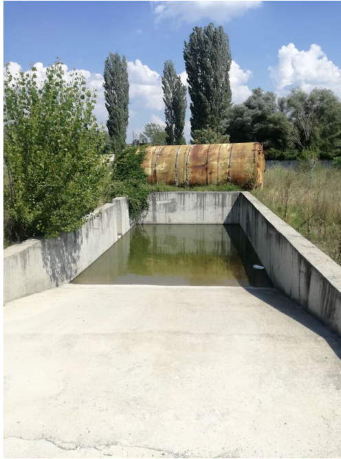
Слика 13 – Таложник за отпадни води од бетонската база
