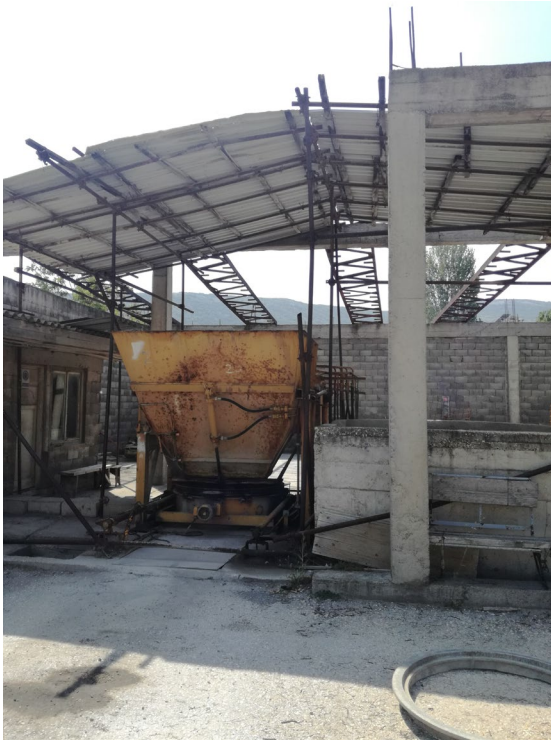
Слика 10 – Машина за производство на бетонски цевки
